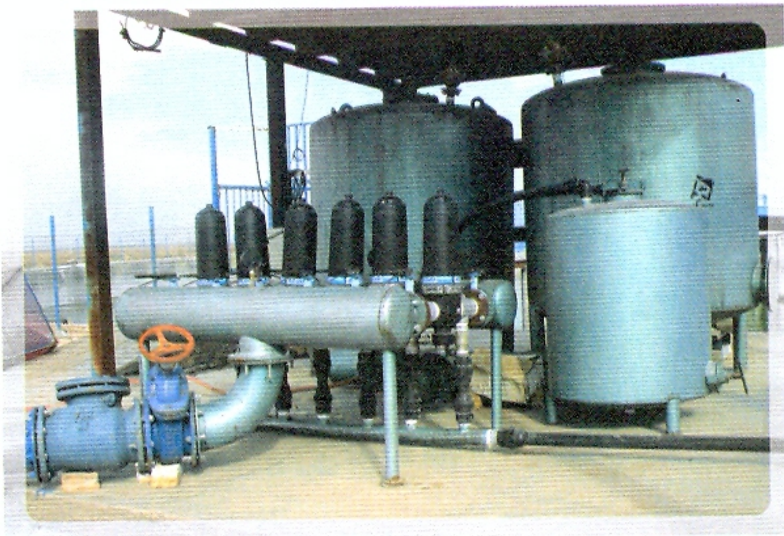
ایستگاه پمپاژ و فیلتراسیون یک سیستم آبیاری قطره ای
